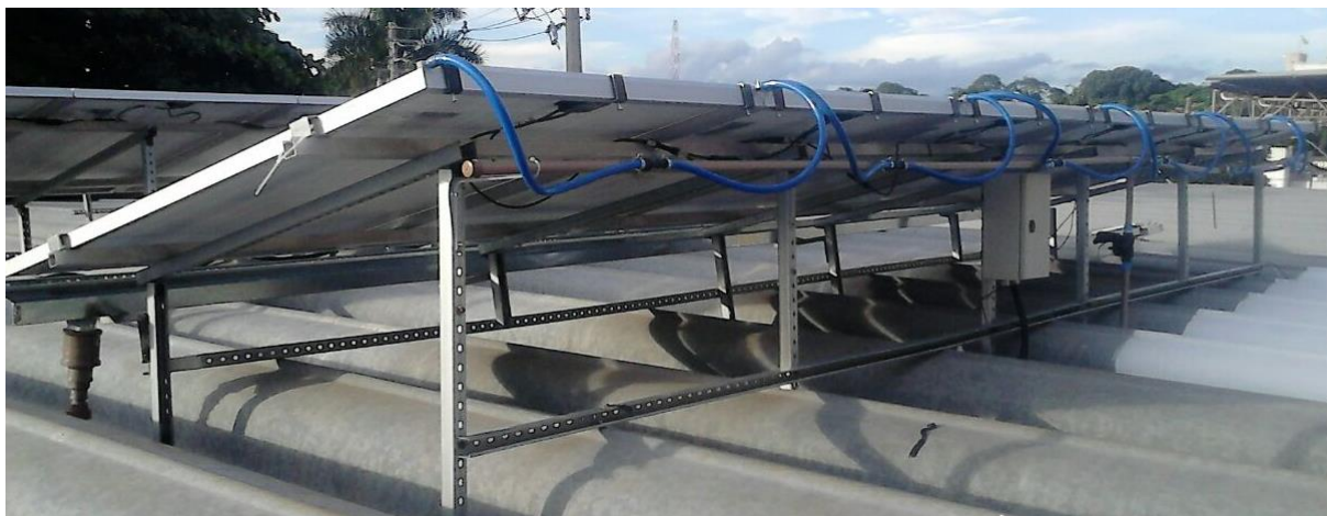
Figura 28 - Instalações para aplicação de água em grupo de seis painéis.
