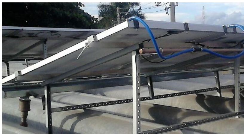
Figura 27 - Tubulação e mangueiras ligadas ao perfil de aplicação de água em um painel.
